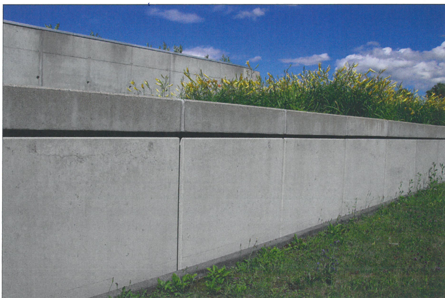
Die Mikroorganismen, die sich an den Außenanlagen angesetzt hatten, waren nach Behandlung mit Heißwasser-Druckstrahl- und Algenentferner verschwunden. (Foto: Torsten Höhne)
