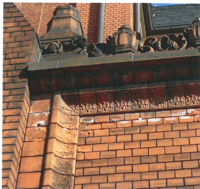
Am Ostflügel des Gotteshauses zeichnen sich deutliche Wasserschäden ab.
