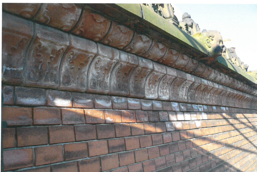
Unübersehbar: Wasserschäden am Mauerwerk der St.-Petri-Kirche. Sie werden mit einer Spezialpaste behandelt, die Kalk und ausgetretene Mineralien bindet.
